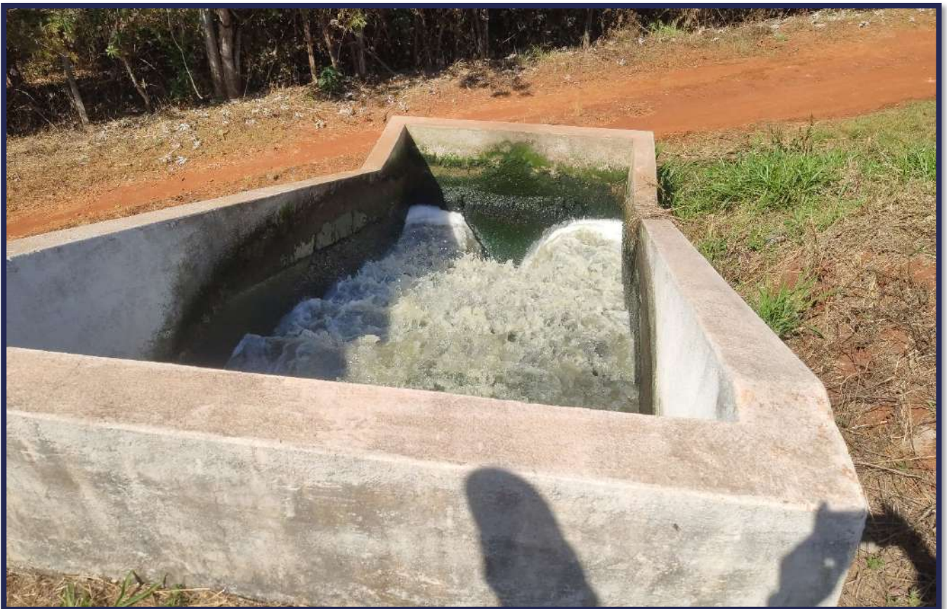
Figura 4-22 - Vista atual das instalações da ETE Vacariú.
