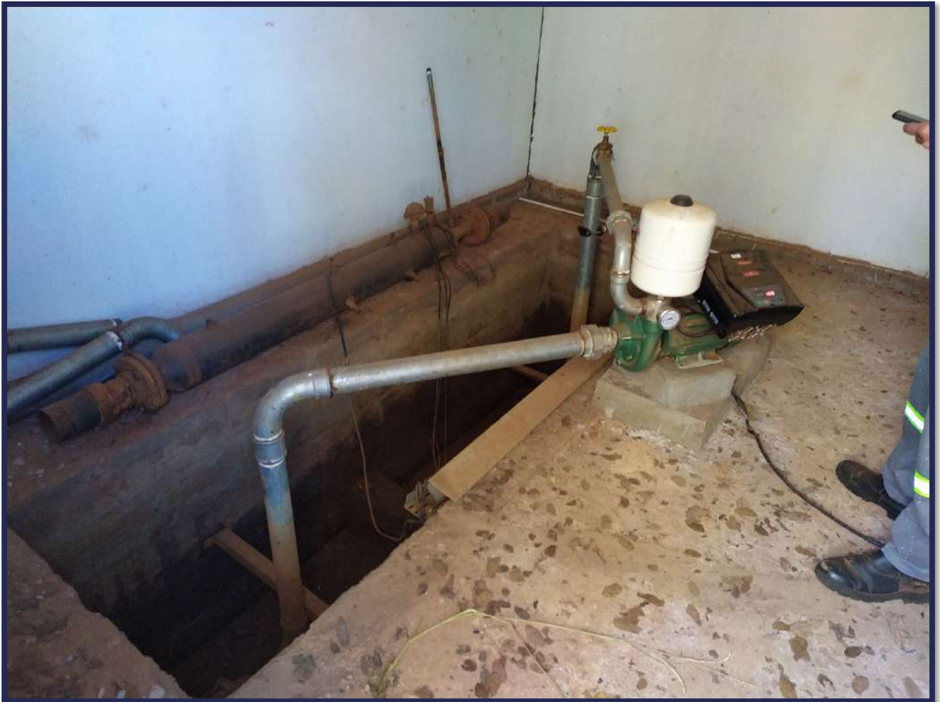
Figura 3-51 - Vista atual das instalações do Booster Itapema.
