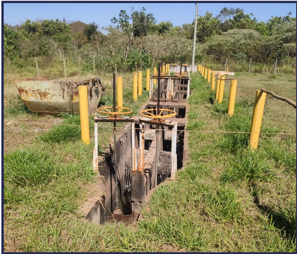
Figura 4-17 - Vista atual das instalaes da ETE Vacari.
